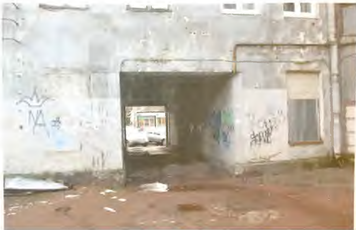
Фото 13. Проездная арка со стороны западного фасада здания. Автор фото: Маланичева Г.И. 30.11.2016 г.
