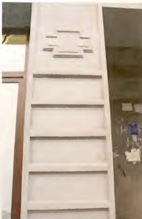
Фото 10.2. Южный фасад здания по улице Пограничная. Вход. Автор фото: Маланичева Г.И. 30.11.2016 г.
