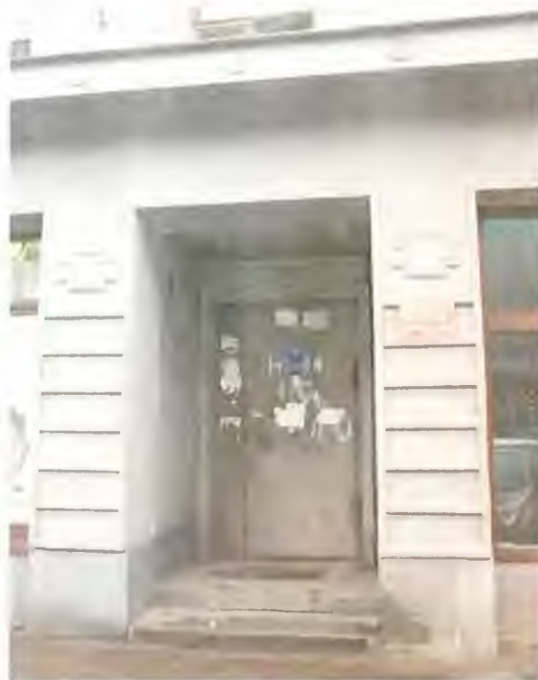
Фото 10. Южный фасад здания по улице Пограничная. Вход. Автор фото: Маланичева Г.И. 30.11.2016 г.
